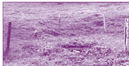
Captage profond avec protection insuffisante.
